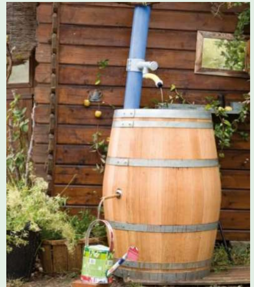
Simple dispositif de récupération des eaux pluviales habillé par un tonneau
